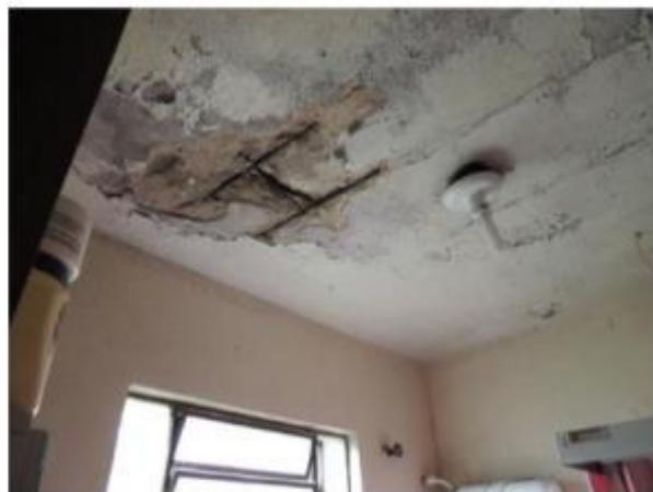
FOTO 10 – Casa Superior – teto do banheiro
